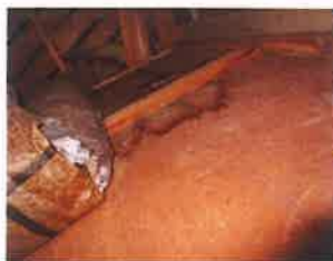
小屋裏水染み
