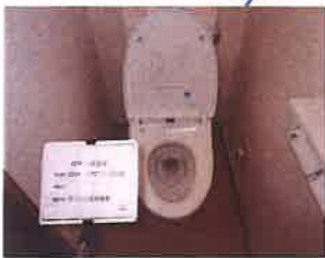
トイレ排水状況
