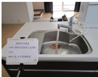
台所吐水状況
