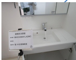
洗面台吐水状況
