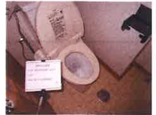
トイレ排水状況
