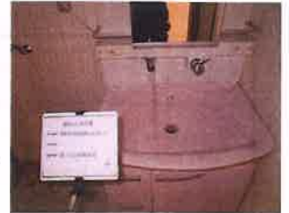
洗面台吐水状況
