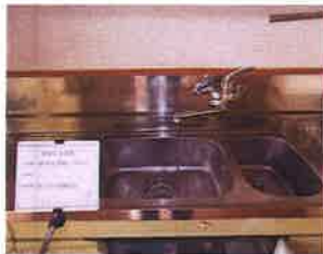
台所吐水状況
