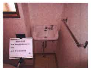
トイレ手洗い吐水状況
